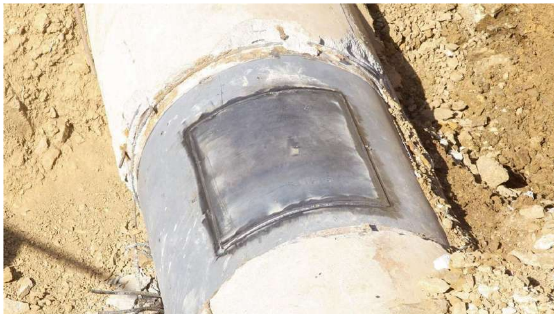
Tubería de agua afectada / M.H
